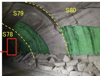
S78~80 南から北向きに撮影 (膨張性地山により施工に難渋した区間付近)
